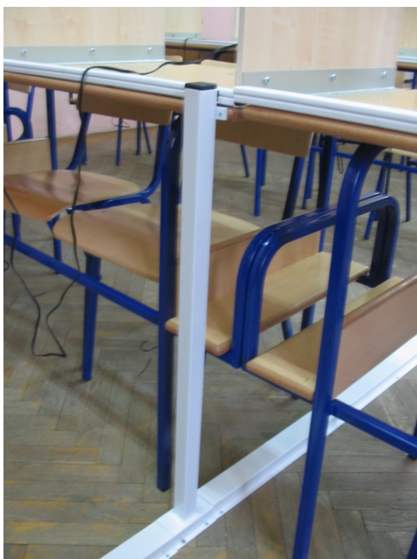
Sl.4 Metalna kanalica za smeštaj instalacije sa razvodnim stubom i plastičnom kanalicom za vođenje instalacije po stolu
